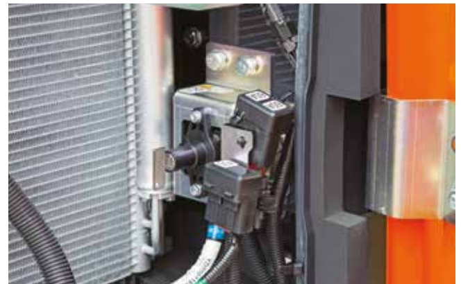
El interruptor de desconexión de batería permite realizar las tareas de mantenimiento de forma segura.
